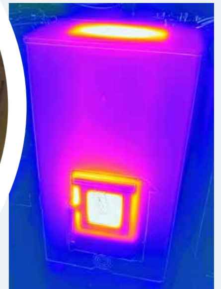
Abbildung 4. Wärmebildaufnahme rund um die Feuerraumtür
